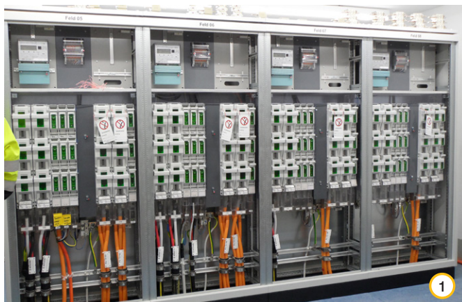
Centrale di distribuzione sotto alla Sechseläuteplatz
